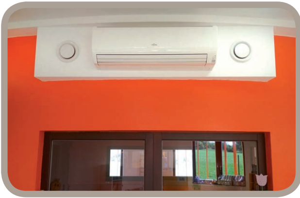
Nová klimatizační jednotka
